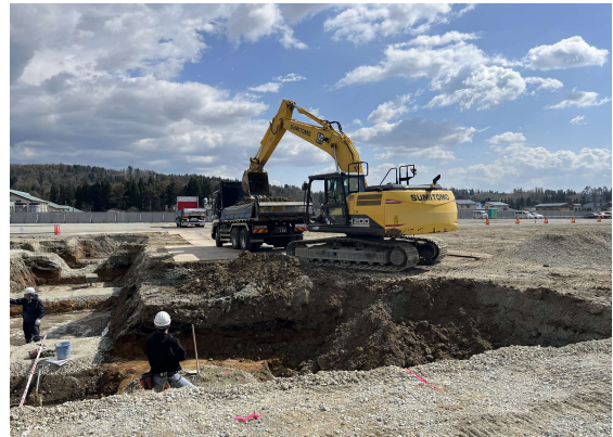
校舎棟の基礎工事を開始。バックホウで掘削作業を行います。
