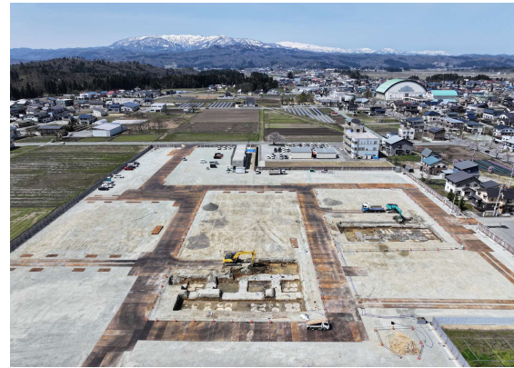
掘削作業の全景（東側から空撮）。写真中央が校舎棟、右側が体育館棟です。
