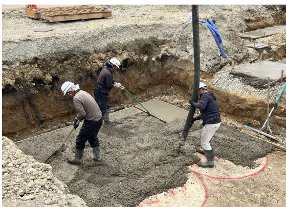
コンクリートポンプ車のホースからコンクリートを流し込んでいます。同時に表面を平滑になります。
