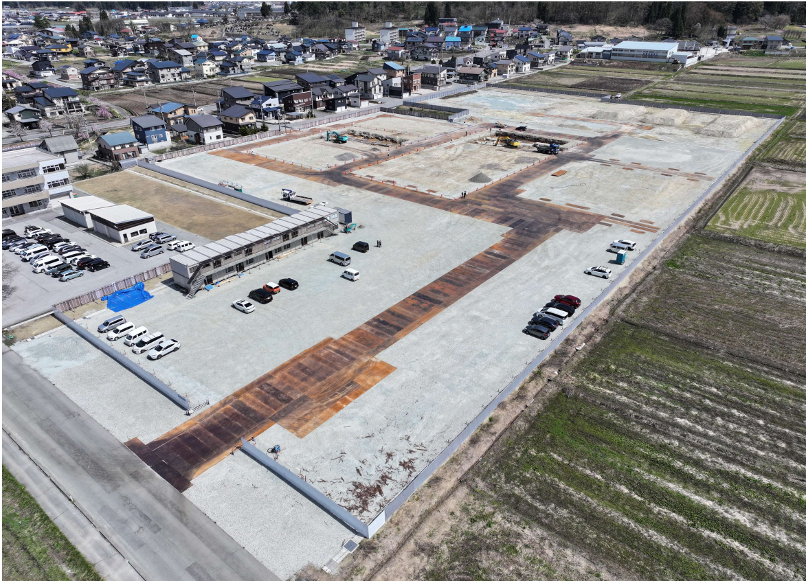
空撮による建設現場の全景（南西側より）【令和8年4月23日撮影】
