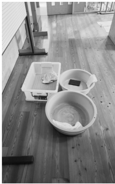
8か所もの水漏れがある
