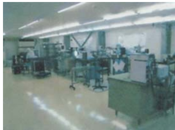
クリーンルーム
