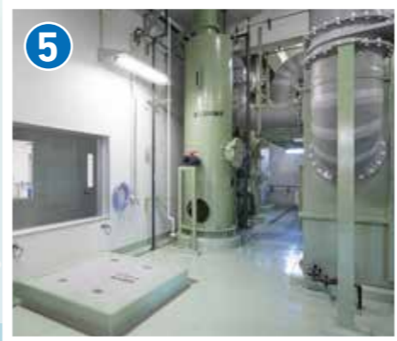
5 高度処理設備
