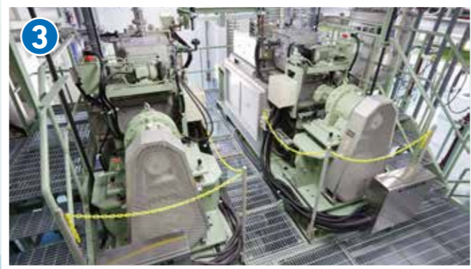
3 前脱水分離設備
