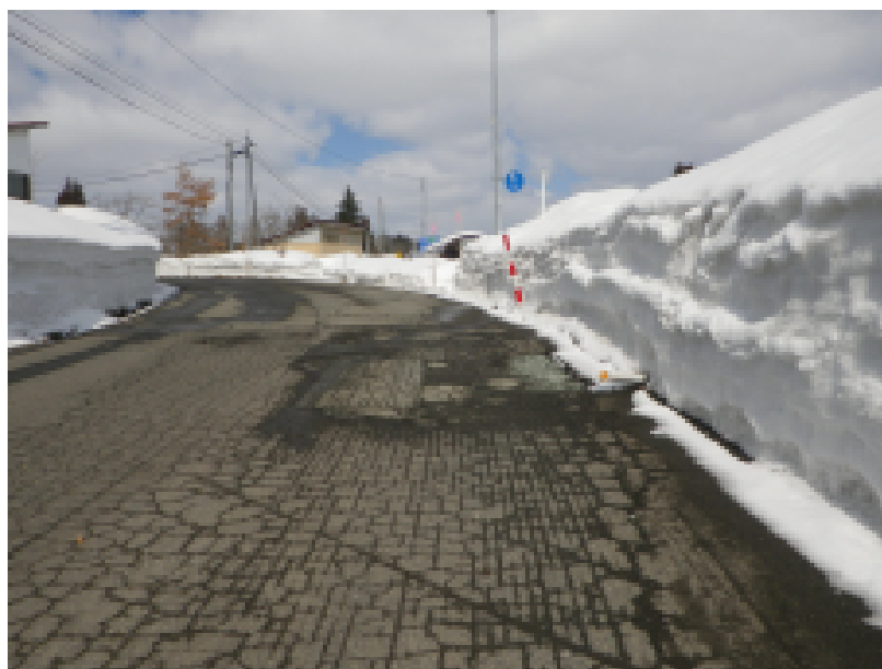
融雪時には各路線で著しい市道の損傷が散見される。
