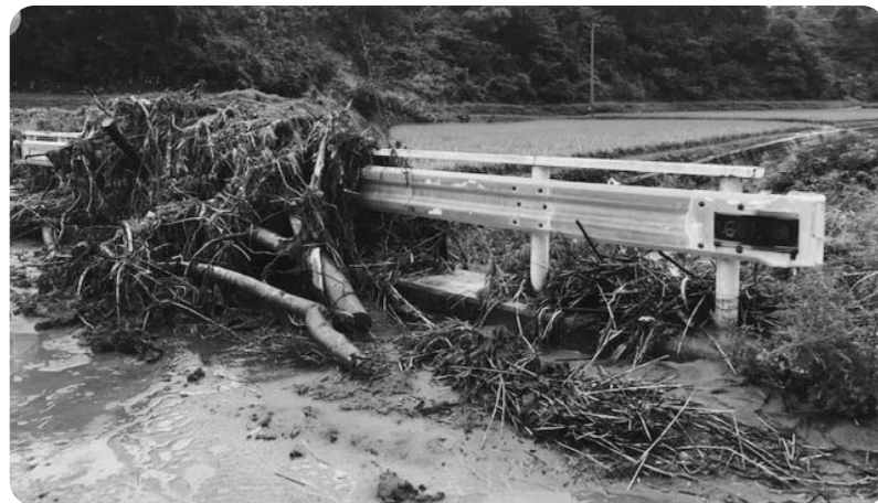
農業施設及び公共土木施設災害復旧事業 2億6,455万円
