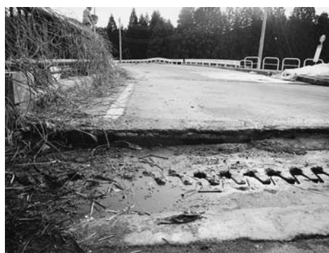
道路災害(芦沢地内)
