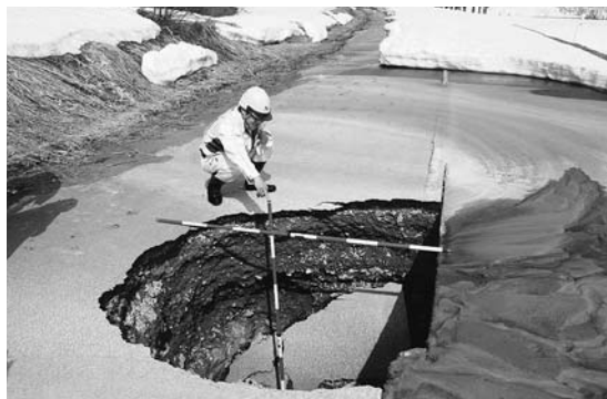
道路災害(田沢地内)
