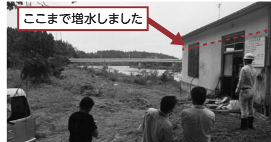
▲農政局立会いの下、揚水施設の被災状況確認(大海平)
