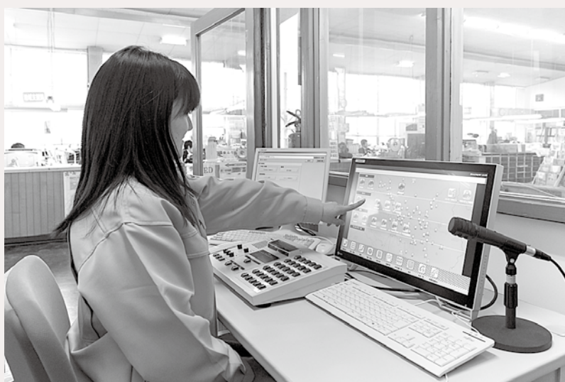
庁舎内に設置された防災無線室
